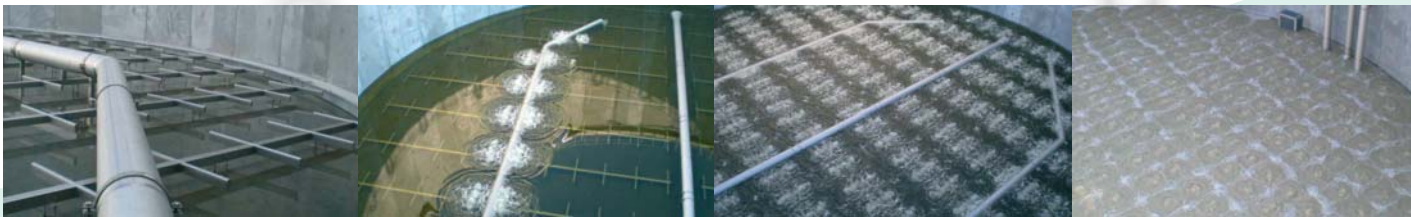
Distintos sistemas de aireación iCBA® montados y en funcionamiento
