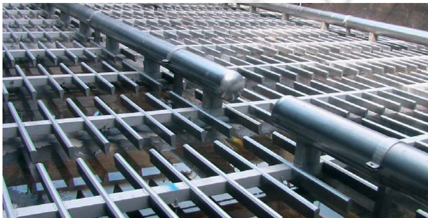
Sistema de aireación iCBA® instalado en una planta industrial de tratamiento de aguas en Suecia (Industria Papelera)
