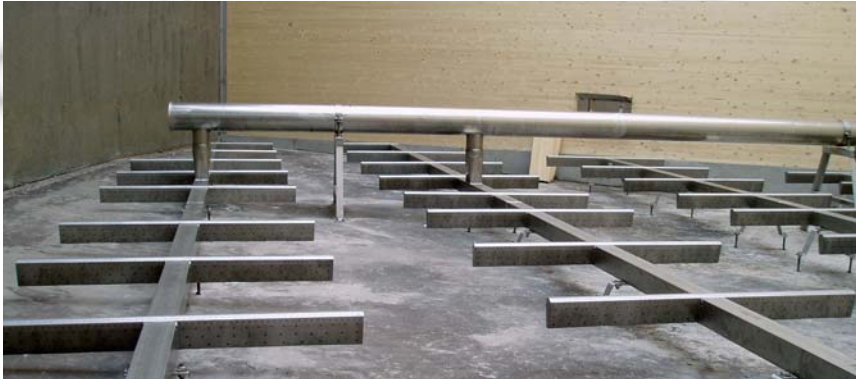
Sistema de aireación iCBA®, antes de la puesta en marcha, en una planta de depuración industrial en Suecia (Industria Papelera)
